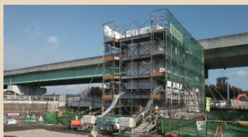
三陸自動車道（仙台市宮城野区—岩手県宮古市）の2車線化工事
