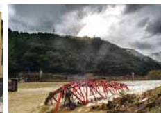
球磨川の氾濫で倒壊した橋梁 (熊本県球磨郡球磨村)
