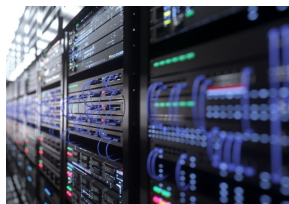
データセンター
